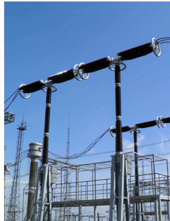
Выключатели 750 кВ (тип GL-318, ALSTOM, Франция)
