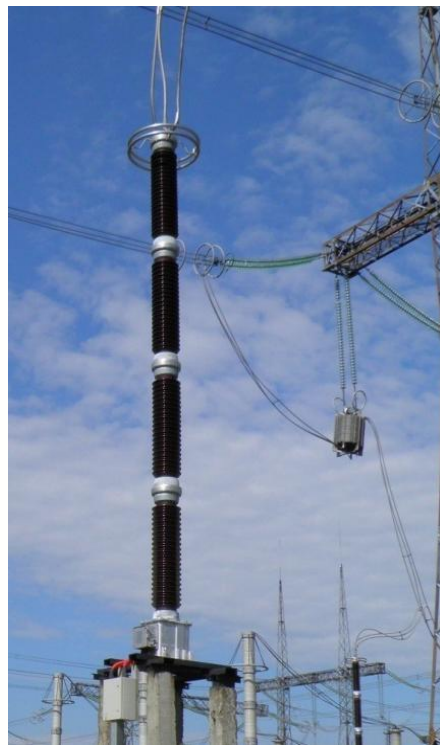
Трансформаторы напряжения 750 кВ (тип TENMF-765 (TRENSH, Германия- Канада)
